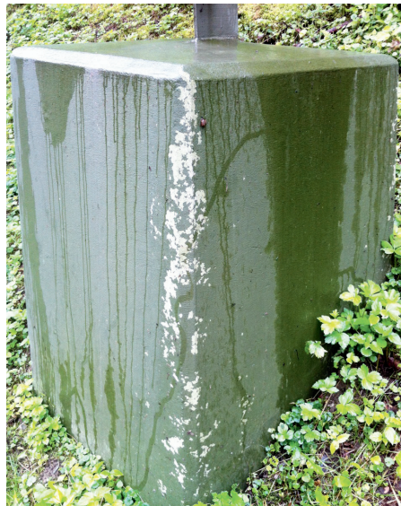
Betonsockel mit beschädigter Beschichtung.
