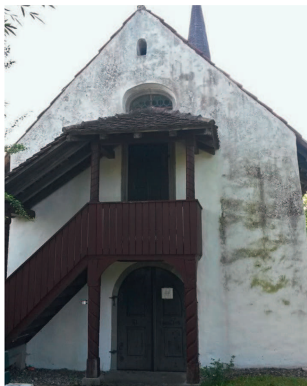
Algen haben sich über die Jahre an der Kalkputzfassade breit gemacht.
