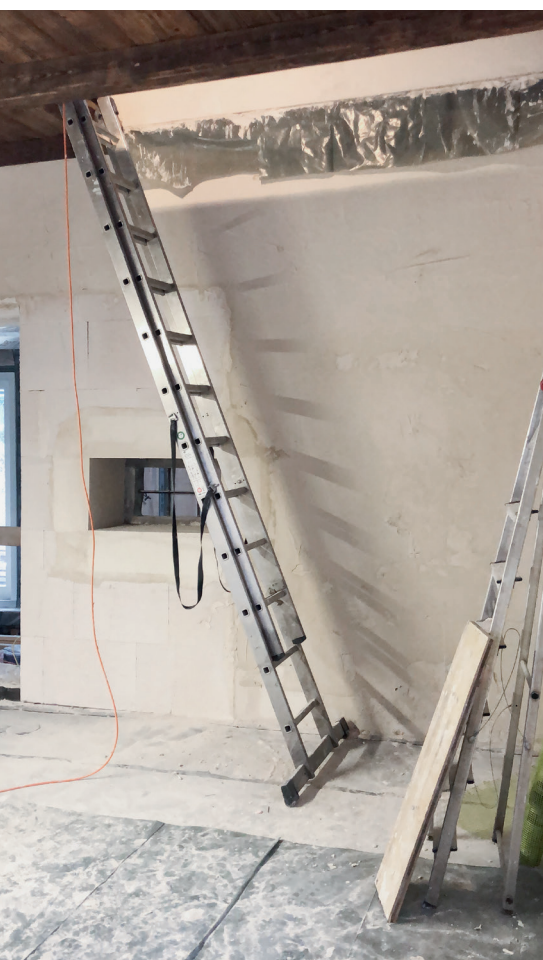
Bei der Innendämmung hat es viele Wärmebrücken, zum Beispiel an der Decke.
