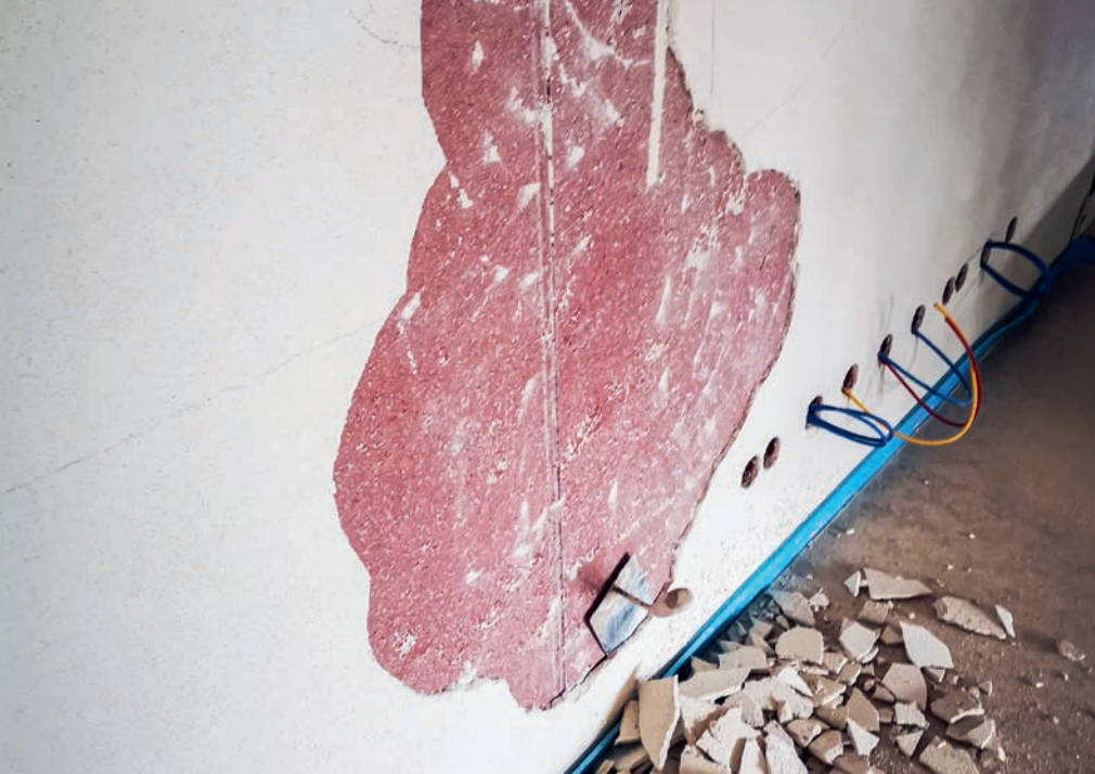
Putzabsturz nach Stemmtest durch Herstellen eines Schlitzes im Gipswandputz.
