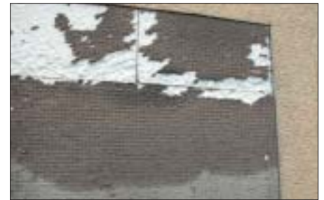
Durchfeuchtungen im Grundputz
