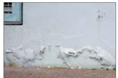
3.1.3.1 Zu hohe Wasserbelastung für die ausgeführte Schutzbeschichtung. (Bild: J. Pfefferkorn)
