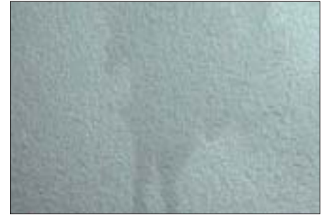
3.1.1.5 Prüfung des Saugverhaltens: stark saugender Deckputz. (Bild: J. Pfefferkorn)
