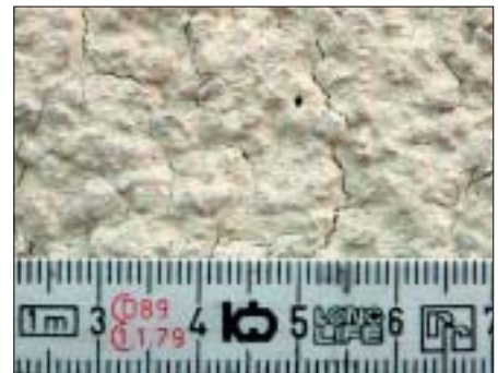
3.2.8 Feine kurze Oberflächenrisse im Kunststoffputz durch schnelle Austrocknung.
