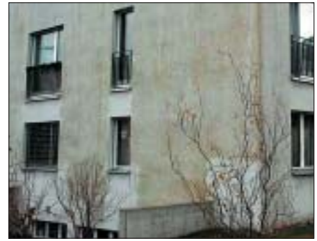
3.2.7 Algenbewuchs begünstigt durch wenig konstruktiven Witterungsschutz.
