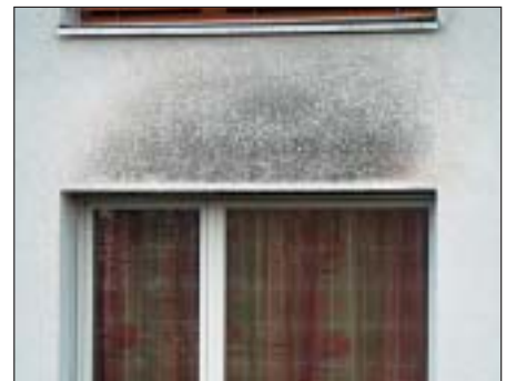
3.2.7 Pilz-Bewuchs durch falsches Lüftungsverhalten.
