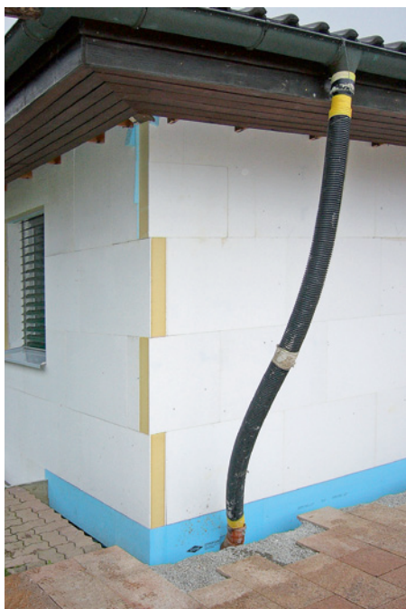
Aufdoppelung der vorschriftsgemäss verlegten Dämmplatten an der Fassade und im Sockelbereich. (Bild: Saint-Gobain Weber)
