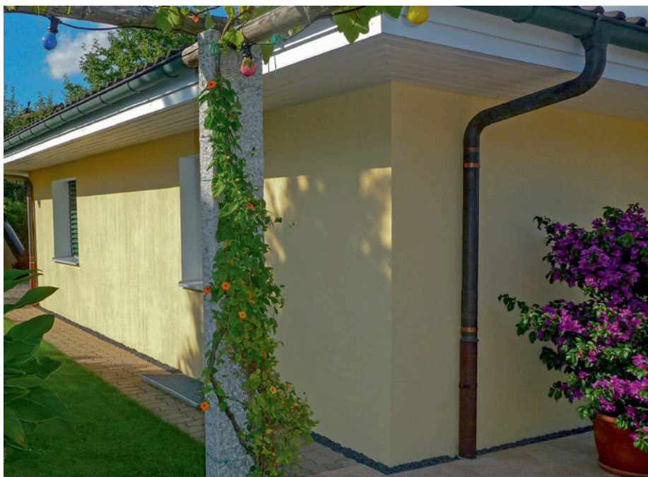
Dieses im Jahr 1985 in Beromünster erbaute Einfamilienhaus wies zu dieser Zeit mit einem U-Wert von 0,3 \text{ W/m}^2\text{K} eine sehr gute Dämmung aus. Für heutige Begriffe ist das zu wenig. Mit der Aufdoppelung konnte der U-Wert auf 0,13 \text{ W/m}^2\text{K} gesenkt werden, was zu spürbaren Einsparungen bei den Heizkosten geführt hat. (Bild: Saint-Gobain Weber)
