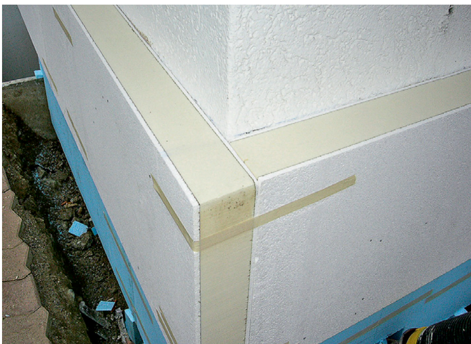
Nach positiv verlaufenen Haftzugtests werden die HiCompact-Dämmplatten von Marmoran direkt vollflächig auf die alte Deckbeschichtung aufgeklebt. (Bild: Saint-Gobain Weber)
