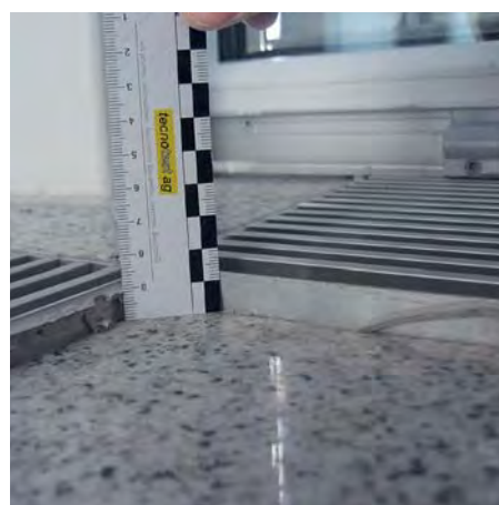
Abb. 13: Absenkung von 15 mm entlang des Kanals.
