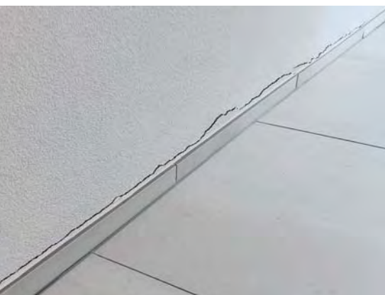
Abb. 16 und 17: Ablösung der Sockelplatte.
