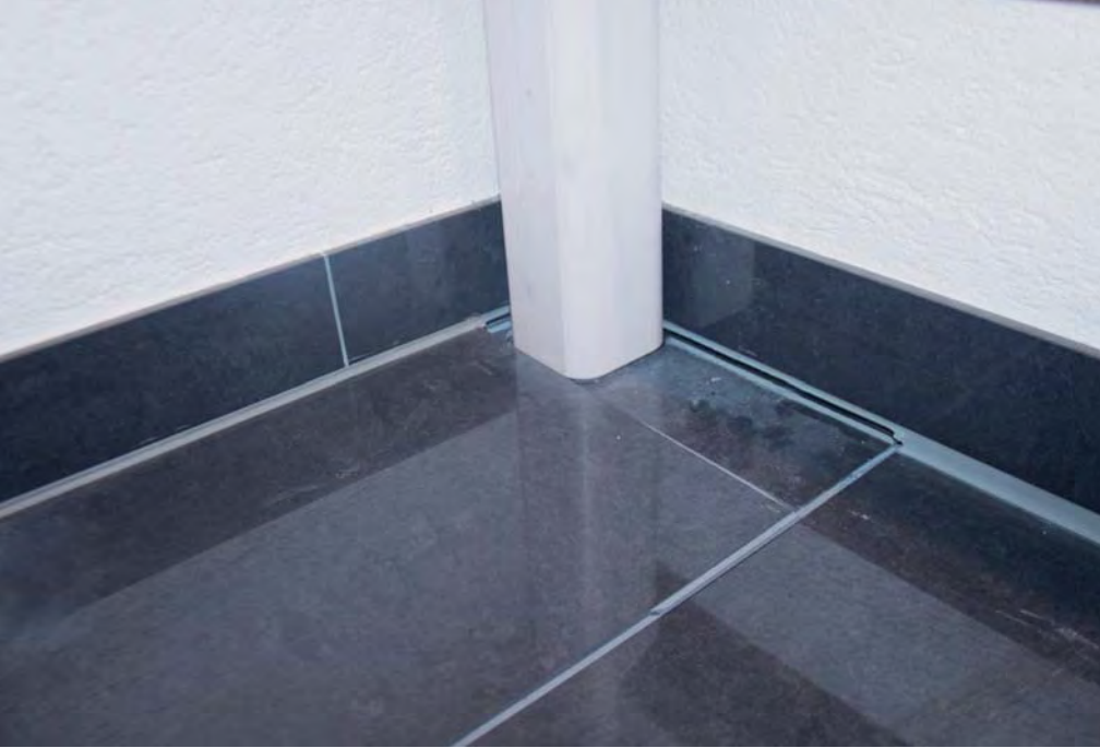
Abb. 18: Drei Folgen der Absenkungen: Links: Platte aus Klebemörtel abgelöst; Mitte: Fugendichtungsmasse gerissen; Rechts: Fugendichtungsmasse stark gedehnt.
