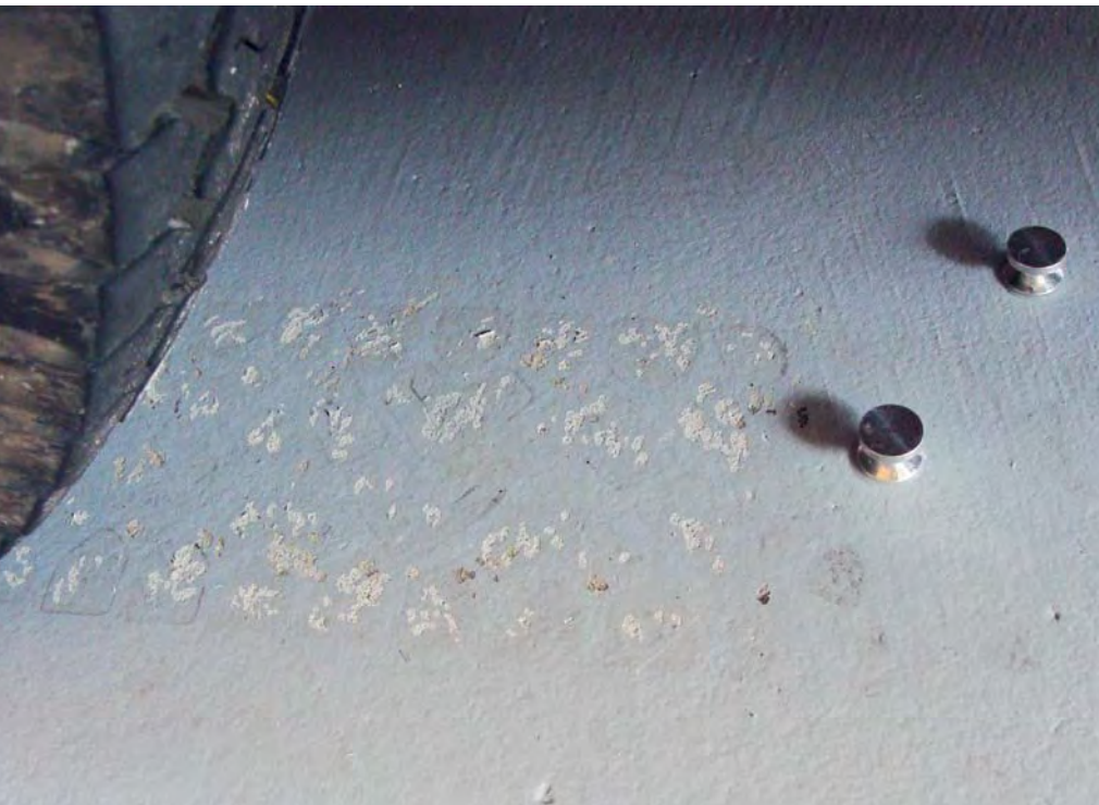
Ablösungen im Fahrspurbereich.
