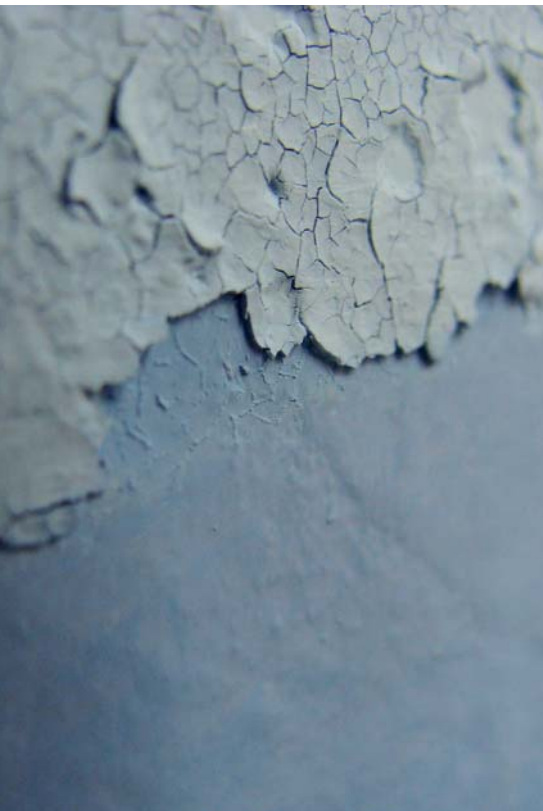
Die Versiegelung konnte aufgrund zu tiefer Temperaturen nicht aushärten.
