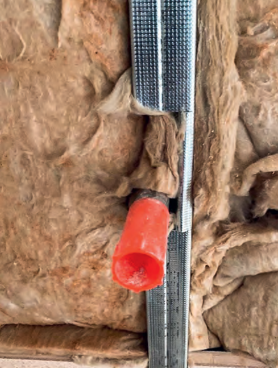
Aus statischer Sicht problematische Schwächung der C-Wandprofile.
