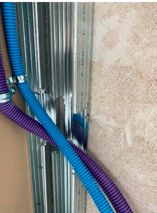
Unerlaubte Schwächungen der Unterkonstruktion durch Installationsleitungen.
