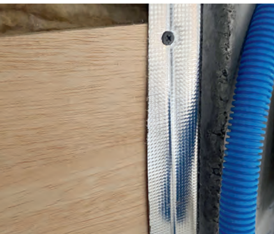
Unfachmännischer Einbau einer Montage traverse in die Unterkonstruktion.
