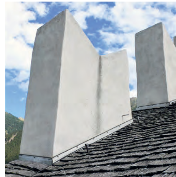
Genereller Zustand der verputzten und ungeschütz- ten Zinnen im Jahr 2019.
