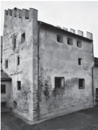
Die gefährdete Ecke des Plantaturms im Jahr 1996.
