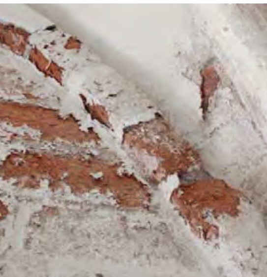
Salzschäden durch Auftausalze.
