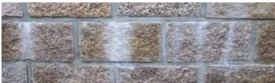
Abplatzungen, Ausblühungen und schwere Salzschäden an einem Mauerwerk.
