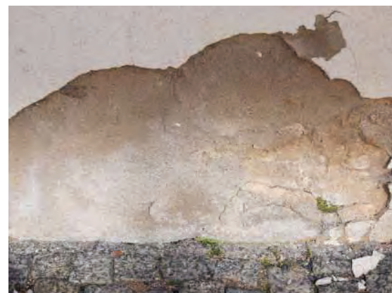
Salzausblühungen auf einer Oberfläche.
