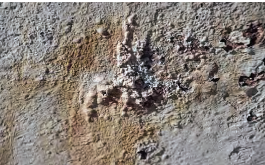
Feuchtigkeits- und Salzaufstieg in einem Mauerwerk.
