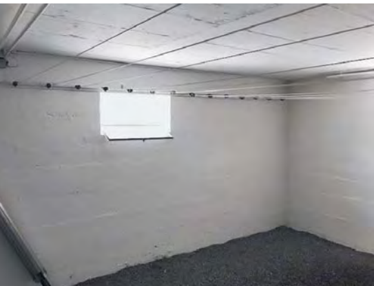
Manchmal kann die Dämmung der Kellerdecke ein erster, dem Budget angepasster Schritt sein.
