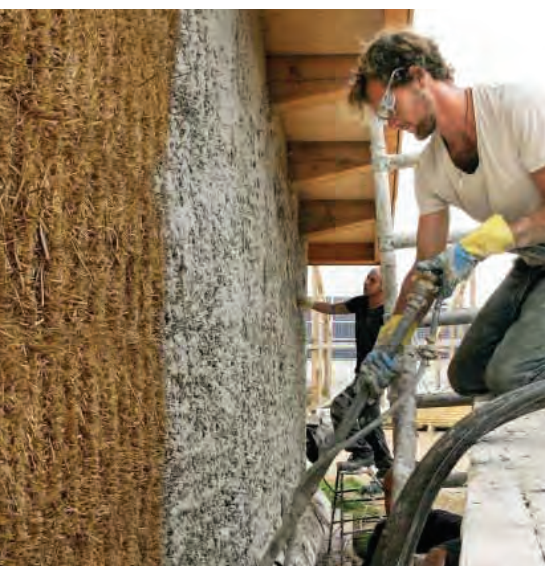
Bilder auf dieser Seite: Das Dämmen mit Stroh ist energieeffizient, das Ergebnis optisch attraktiv. (Bilder: Gräfix)
