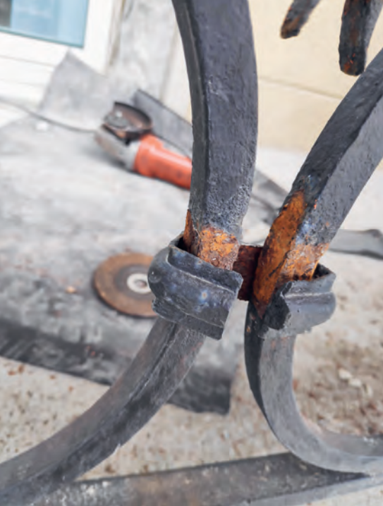
Beispiel eines frisch sandgestrahlten und dann neu beschichteten Geländers. Der Rost unter den Bündeln ist geblieben. (Bild: Lukas Arbenz)
