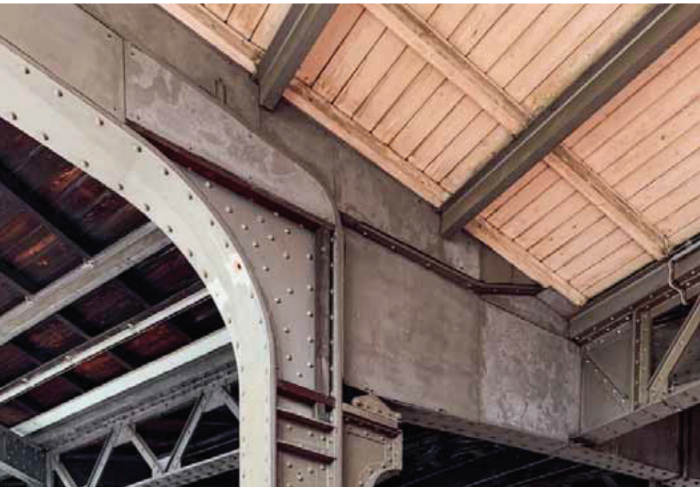
Der Zustand der Perronhalle vor Beginn der Arbeiten. (Bilder auf dieser Doppelseite: Hans Gassler AG)
