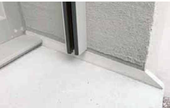
Putzbordanschluss mit sichtbarem Fugendichtungs- band.
