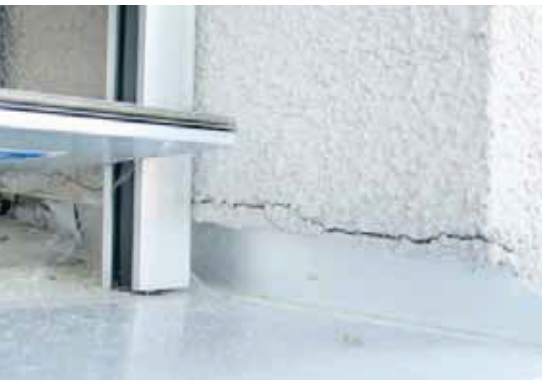
Unkontrollierter Putzabriss aufgrund des fehlenden Trennschnitts bei starrem Putzbord.
