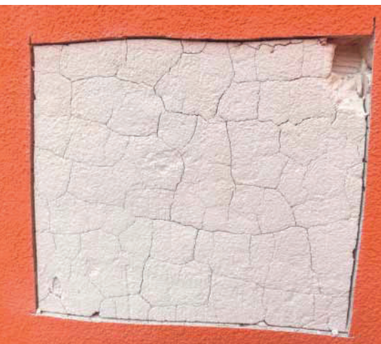
Ausgeprägte Schwindrissbildungen im Dämmputz unter hohl liegendem Deckputz.
