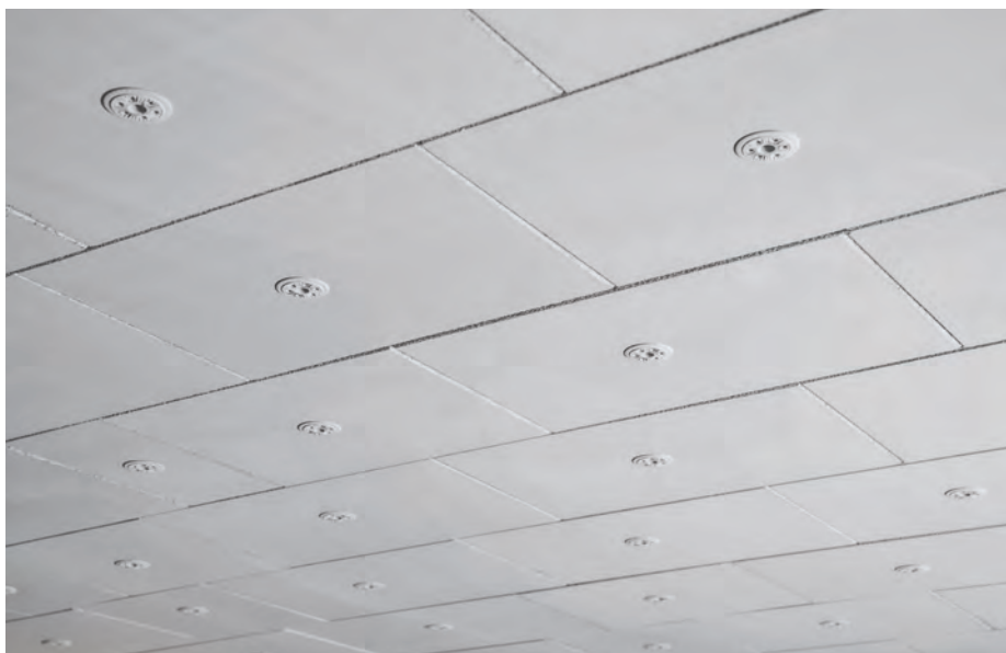
Eine mit SwissporEcorit gedämmte Decke.
