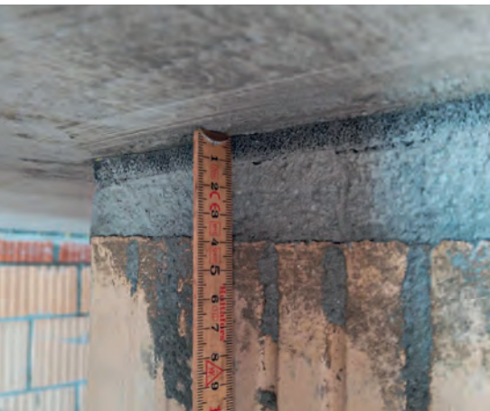
Zu hoher Mörtelglatstrich. Es empfiehlt sich, eine rissüberbrückende Massnahme mit zum Beispiel einer Putzträgerplatte vorzunehmen.
