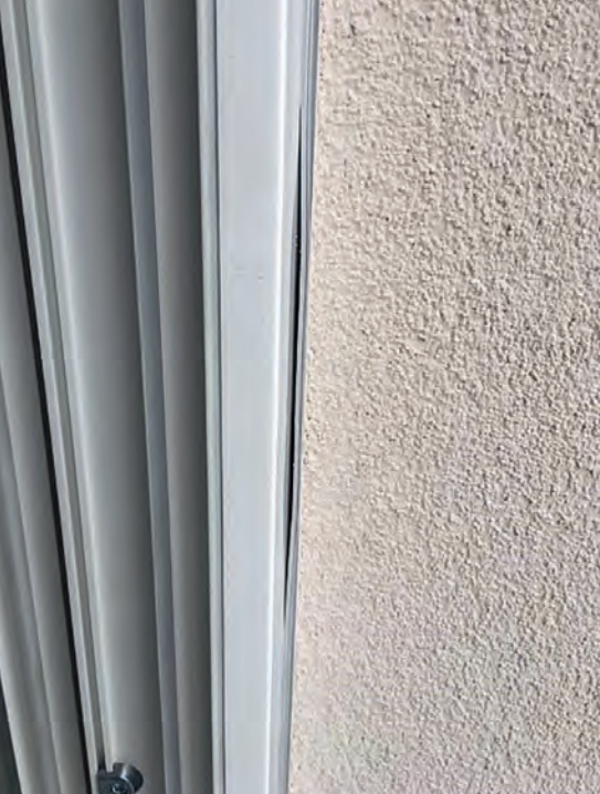
Im eingebauten Zustand ablösendes Profil. Klaffende Fuge zwischen Putz und Fensterstock. (Bild: Kp-Tec)
