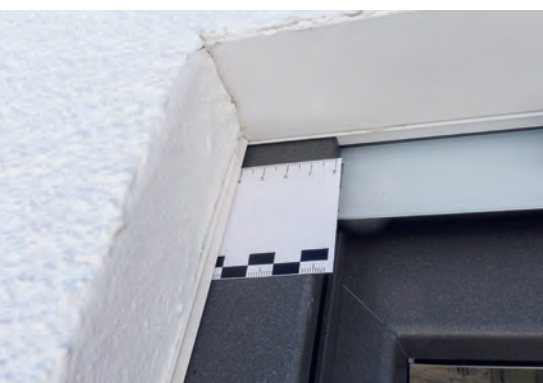
Losgelöstes Putzanschlussprofil. (Bild: Stefan Müller)
