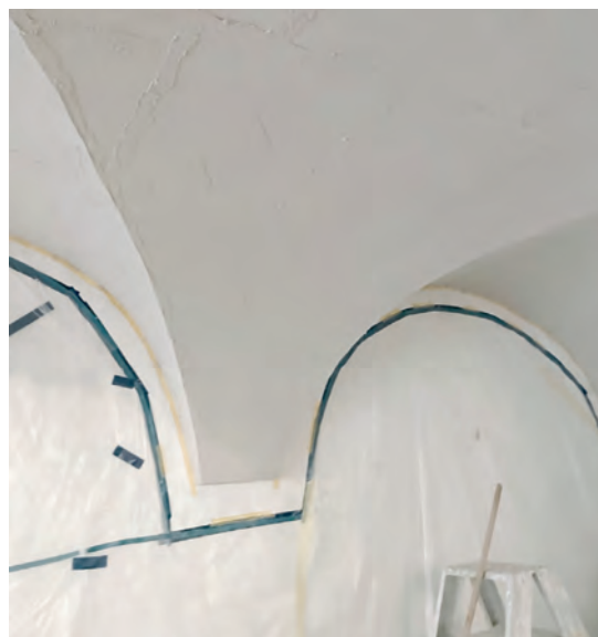
Schwierige Anschlüsse auf dem Klosterverputz.
