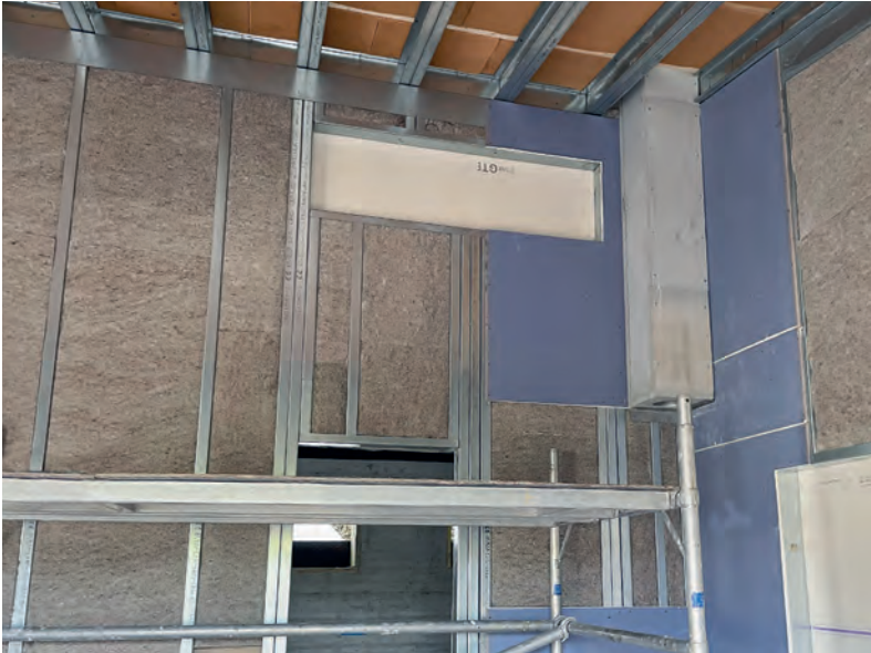
Die tragenden C-Träger-Wandprofile sind mit natürlicher Schafwolle ausgefüllt und innenseitig mit aussteifenden Hartgipsplatten verkleidet.
