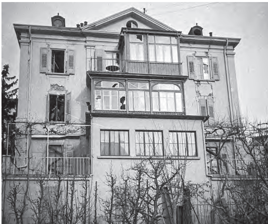
Schäden nach dem Beben von Sierre VS im Jahr 1946. Quelle: seismo.ethz.ch
