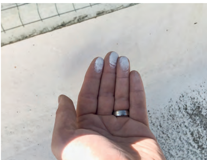
Ein Darüberstreichen mit den Fingern zeigt bereits deutlich die Auskreidung.
