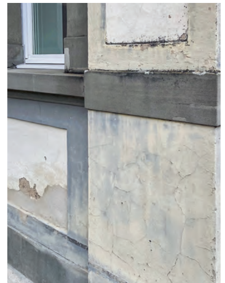
Früher oder später wäre der Oberputz schollenförmig vom Mauerwerk abgelöst. Bild: zVg
