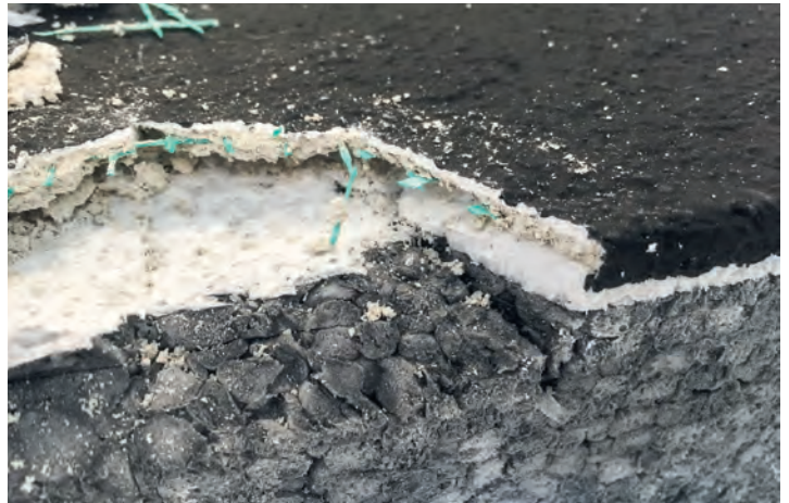
Diese EPS-Dämmplatte hat sich durch Überhitzung deformiert, weil die Beschichtung zu dunkel ist. Bild: Kabe Farben
