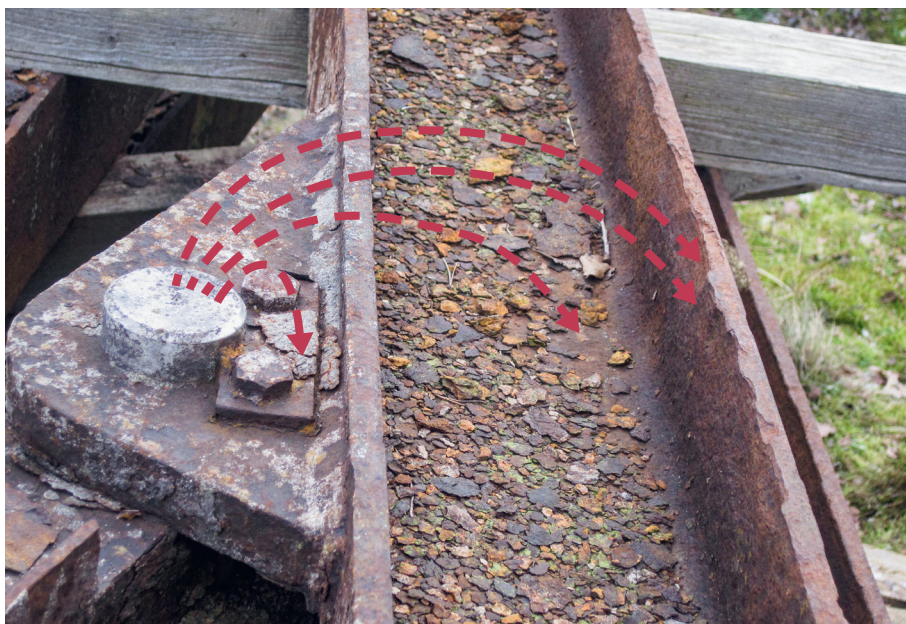
Abb. 9: Nachvollzug des (ionaren) Korrosionsstroms zwischen («edlerem») Bolzen und («unedlerem») Baustahl des Ständers.
