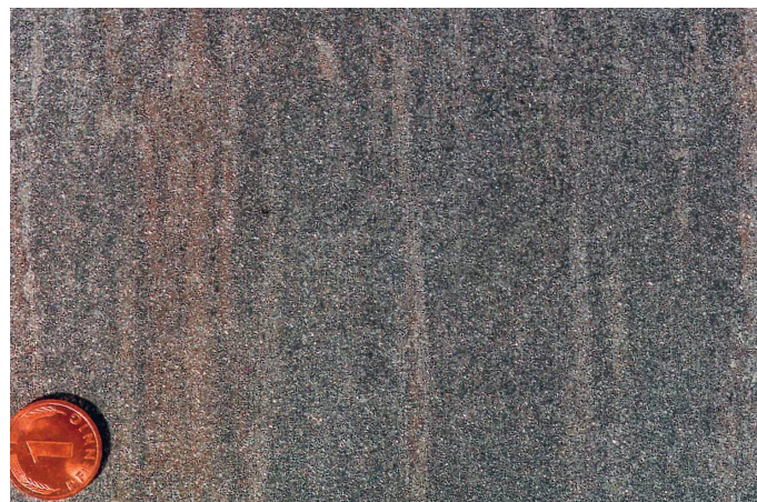
Norm-Reinheitsgrad Sa 1 – ausgehend von Rostgrad A: Zunder und Rost sind nur teilweise entfernt.
