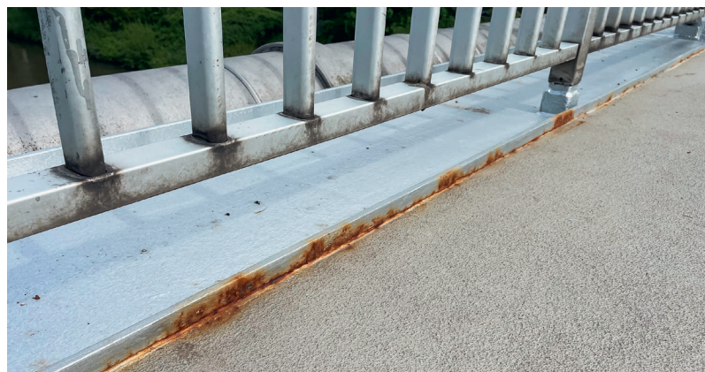
Bereits zwei Jahre nach der Applikation der Korrosionsschutzbeschichtungen trat Korrosion durch Salze auf der Stahloberfläche auf.
