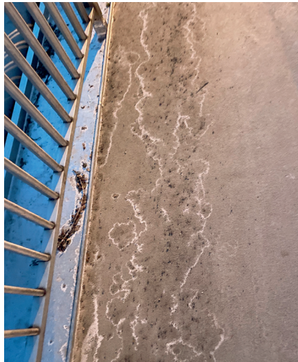
Salziger Brückenbelag vor der Applikation einer Korrosionsschutzbeschichtung.
