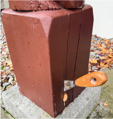
Die Ölfarbe erschwert die Abtrocknung von Feuchte. Holzfäule ist das Ergebnis.
