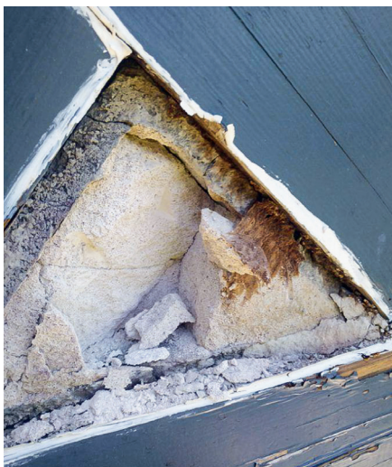
Schaden an einer bewitterten Fachwerkfassade. Unter der diffusionsdichten Ölfarbe zeigt sich das bereits durch Holzfäule geschädigte Holz.
