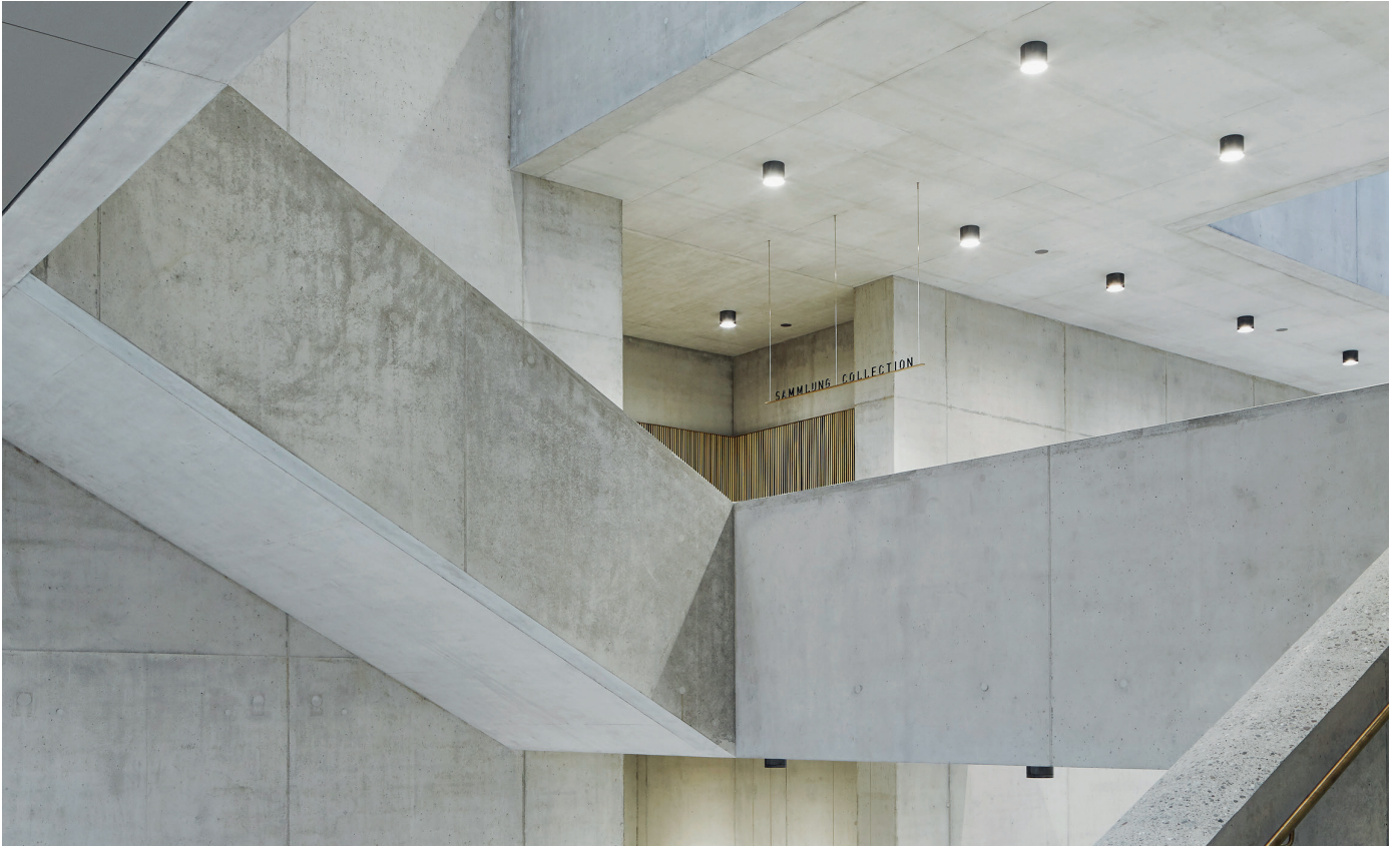
Die Oberflächen mit RC-Beton beim Kunsthaus in Zürich sind gleichmässig und frei von optischen Verfärbungen. Bild: Kunsthaus Zürich
